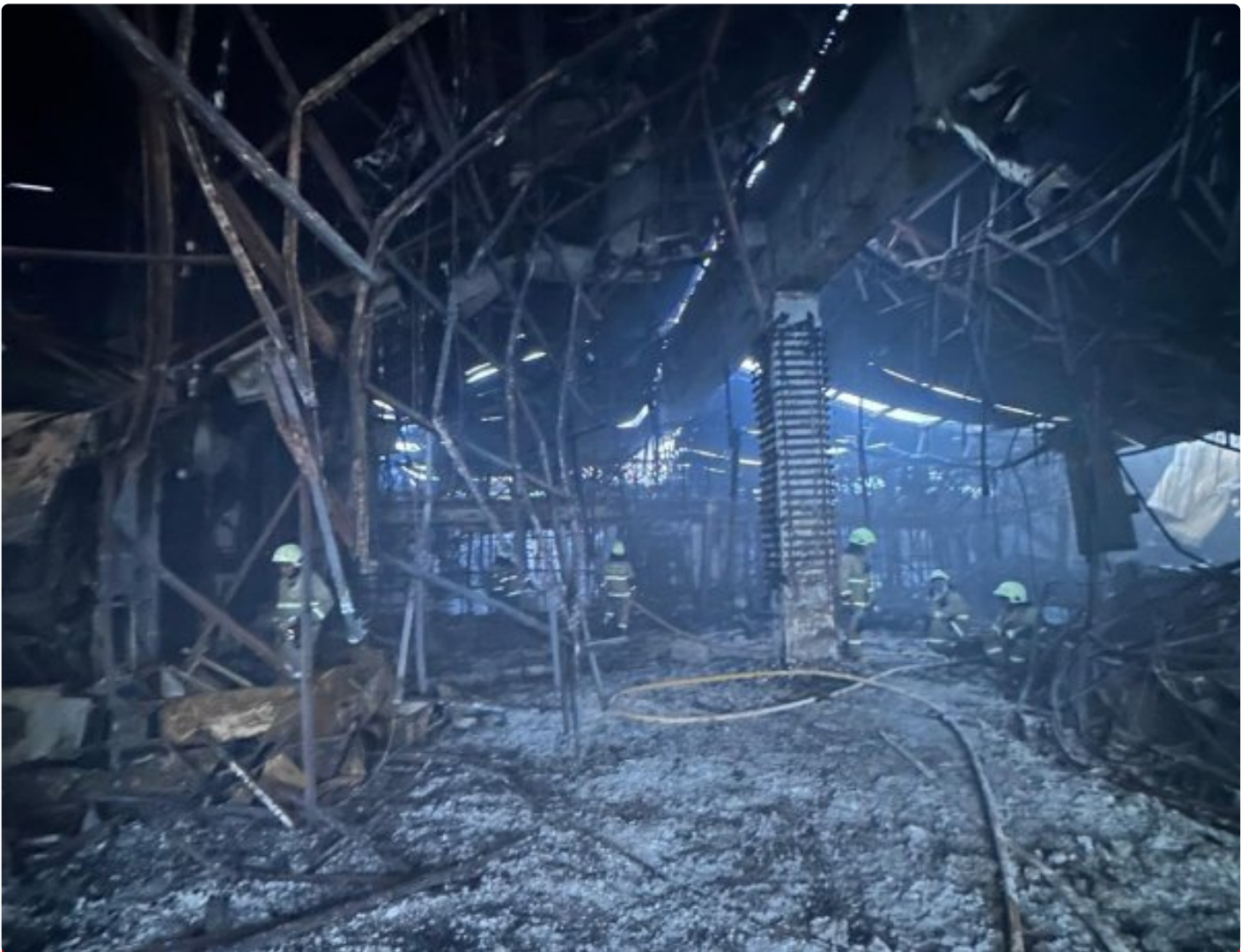
Glodok Plaza yang Hangus Terbakar
